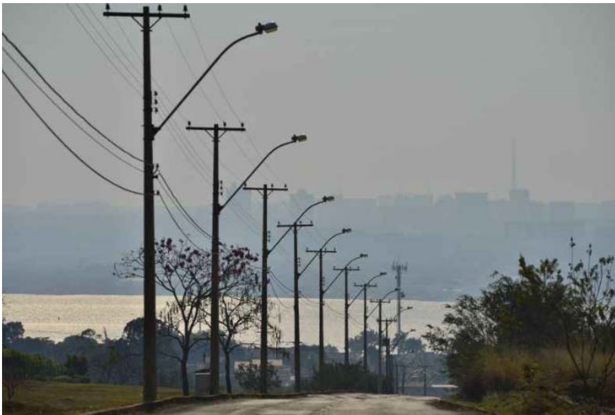
Figura 13 – Postes de Distribuição de Energia Elétrica Fonte – Site Correiobraziliense.com.br - Acessado em 11/04/2024.
