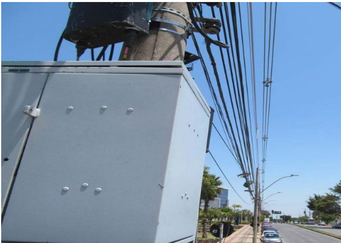
Figura 21 – Estação RG51 em Poste de Luz Fonte – Levantamento Técnico município de Belo Horizonte/MG
