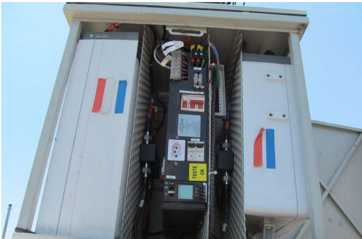
Figura 22 – Equipamentos Estação RG31 Poste de Luz Fonte – Levantamento Técnico município de Belo Horizonte/MG
