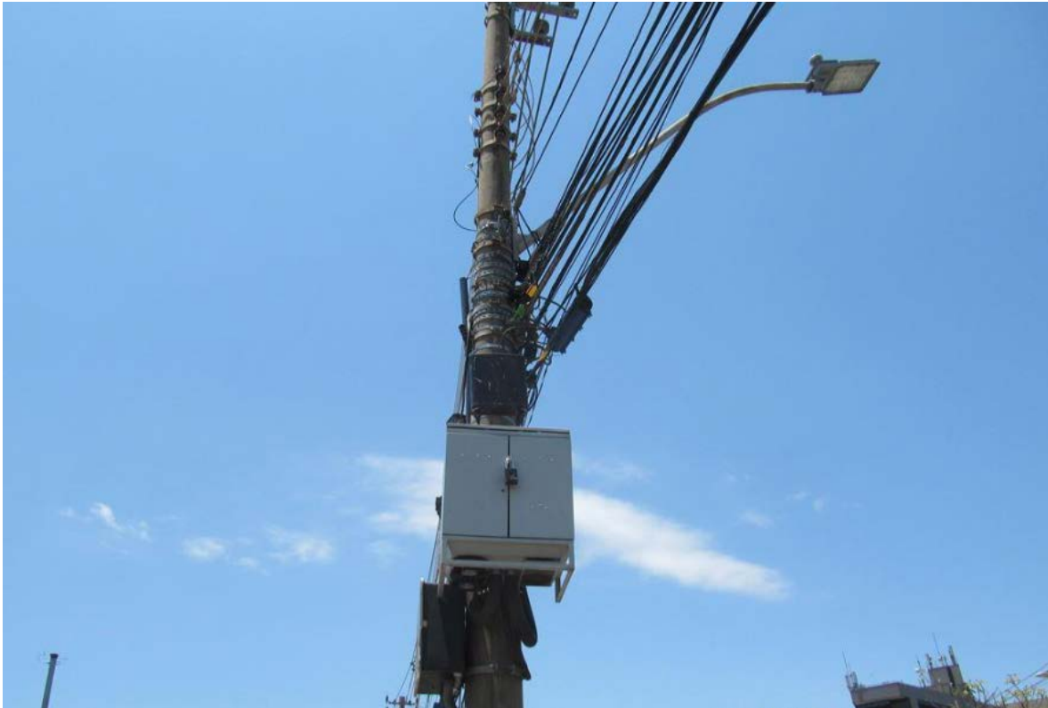
Figura 20 – Estação RG41 em Poste de Luz Fonte – Levantamento Técnico município de Belo Horizonte/MG
