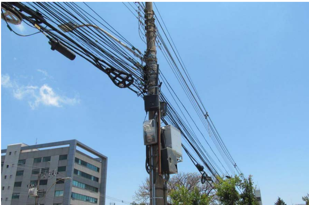
Figura 18 – Estação RG11 em Poste de Luz Fonte – Levantamento Técnico município de Belo Horizonte/MG
