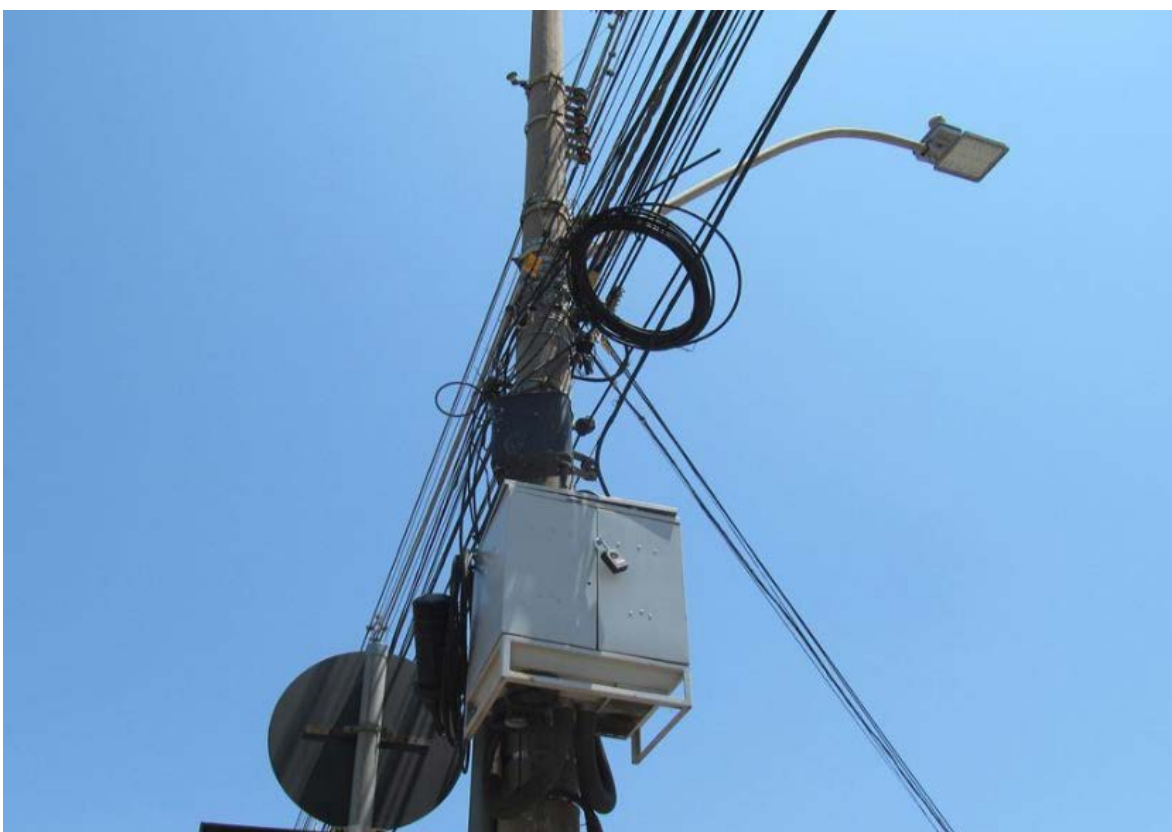
Figura 19 – Estação RG31 em Poste de Luz Fonte – Levantamento Técnico município de Belo Horizonte/MG
