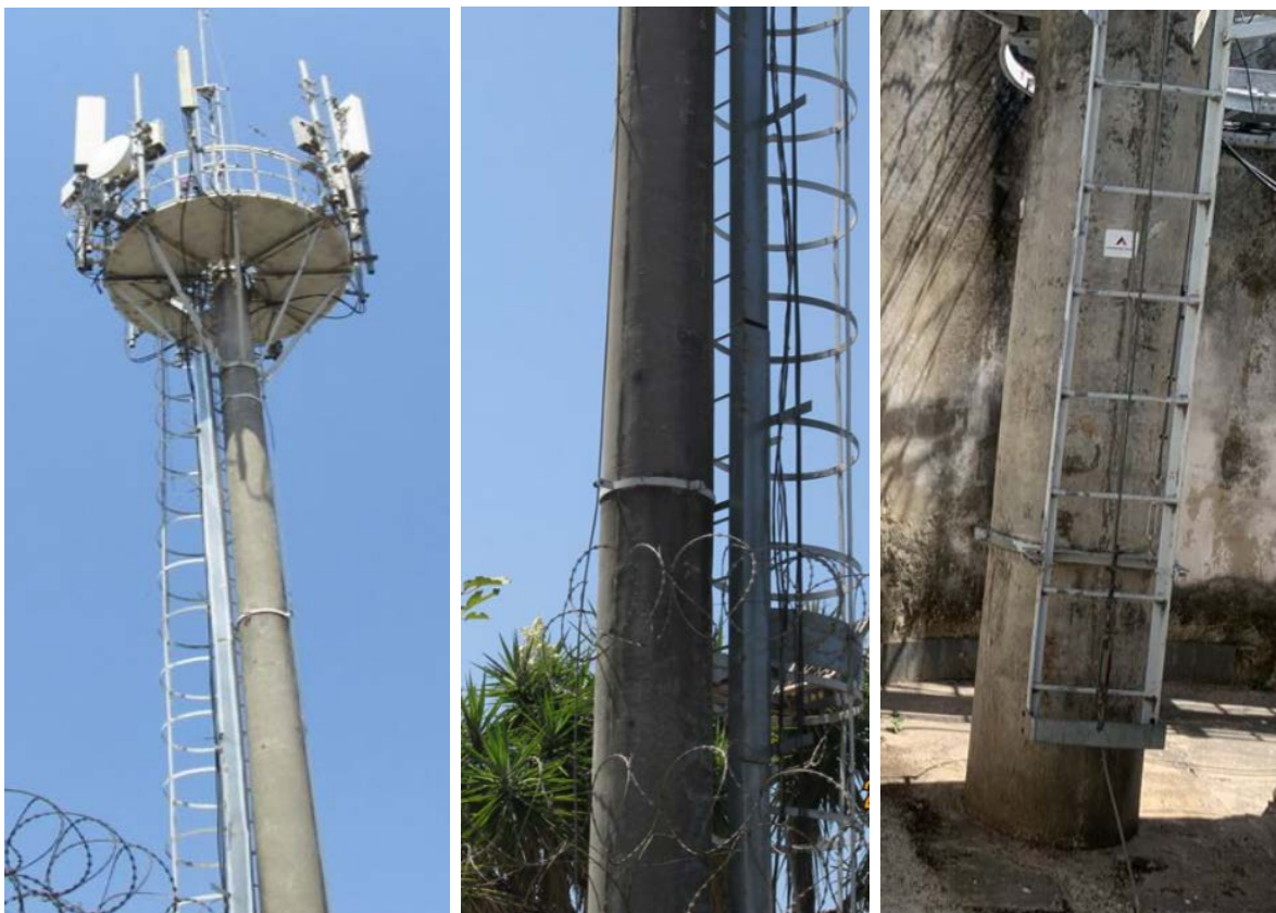
Figura 7 – Poste de Concreto Fonte – Levantamento Técnico município de Belo Horizonte/MG
