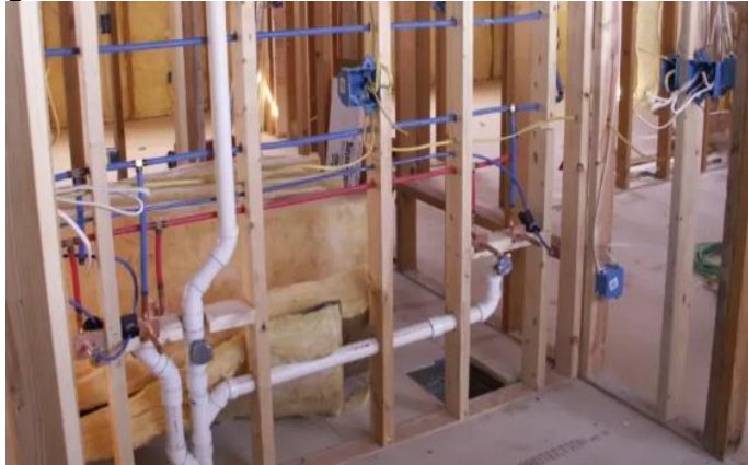
Figura 11 - Sistema elétrico e hidráulico wood frame
