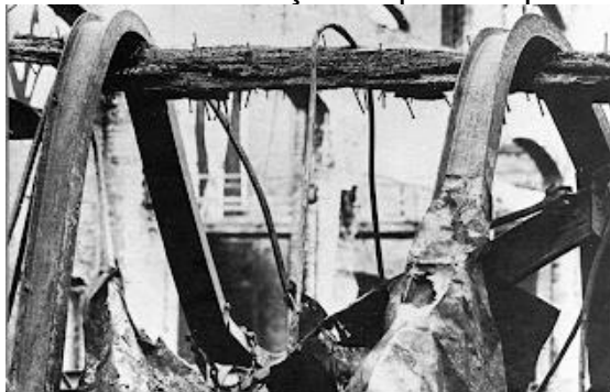
Figura 3 - Estrutura de aço colapsada após incêndio
