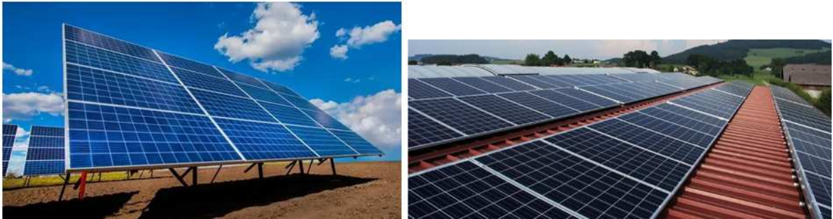
Figura 1 - Painel solar com estrutura no telhado e solo
