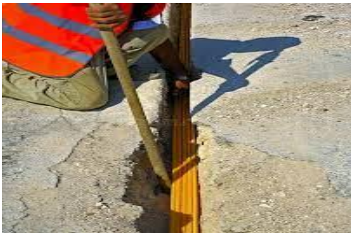
Figura 16– Acomodação do Cabo Óptico
