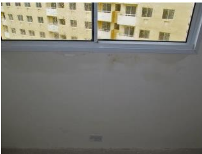
Figura 12 – Infiltração na esquadria da sala
