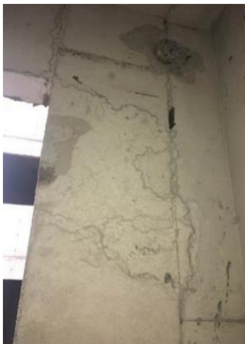
Figura 25 – Segregação “B” entre 1,3 e 2,0 metros do piso
