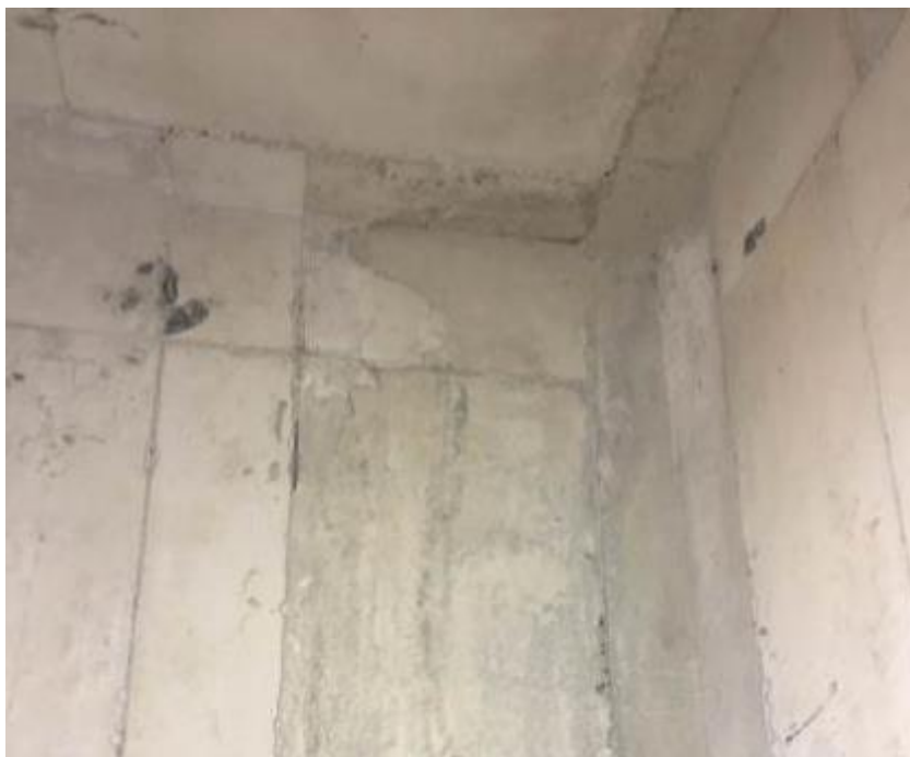
Figura 26 – Segregação “C” acima de 2,0 metros do piso
