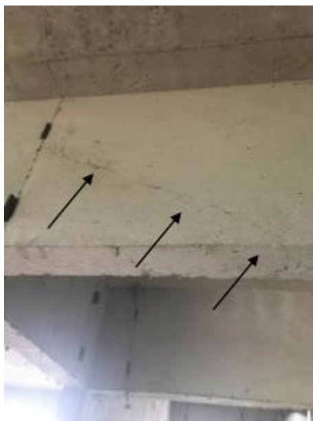
Figura 19 – Fissura formando ângulo com abertura de porta
