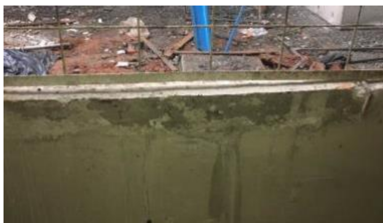
Figura 29 – Problema na aplicação do concreto no contramarco da janela
