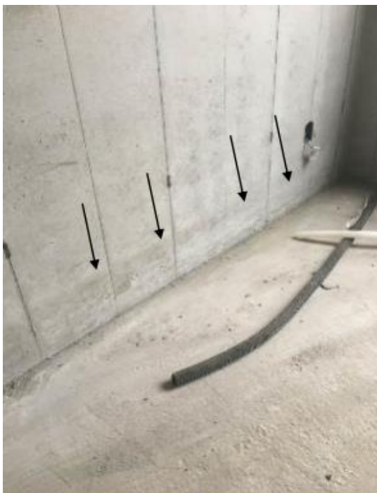
Figura 24 – Segregação “A” até 1,10 metros do piso
