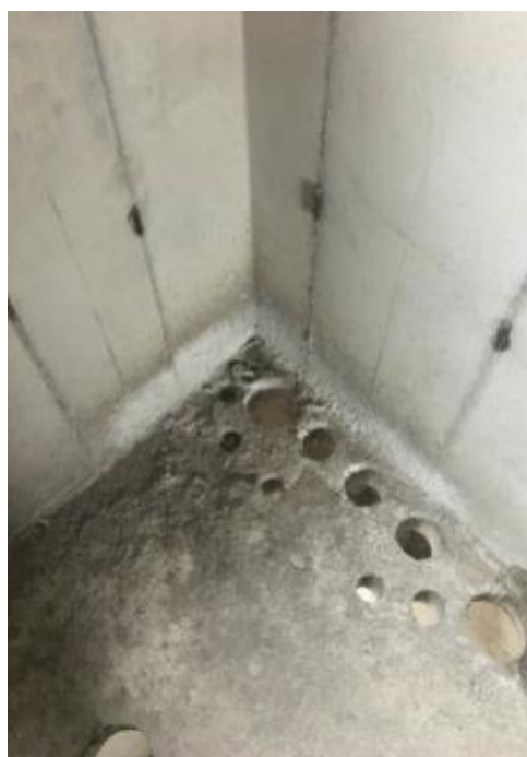
Figura 32 – Vazamento de nata de concreto devido à separação entre as placas
