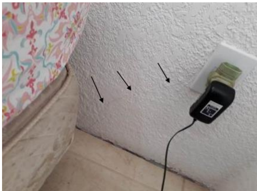
Figura 13 – Fissura na parede partindo da caixa elétrica
