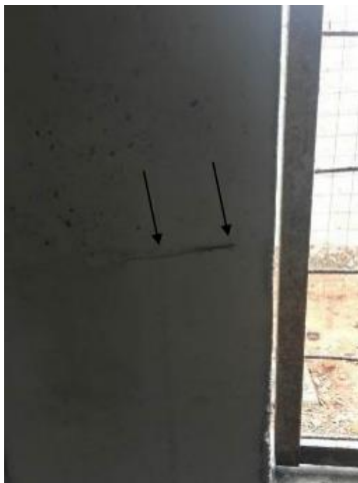
Figura 27 – Armadura exposta na superfície do concreto
