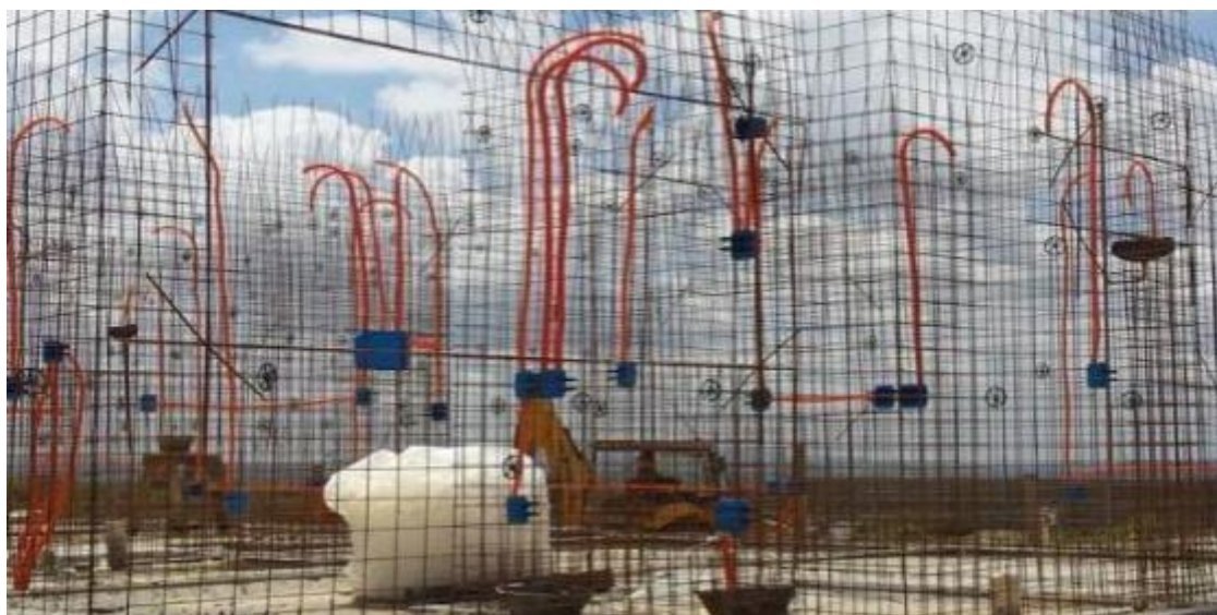
Figura 5 – Sistema de armaduras e instalações embutidas para paredes de concreto moldadas in loco
