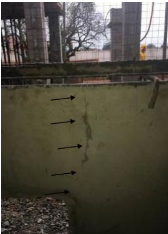
Figura 20 – Fissura a 90° entre vão da janela e abertura
