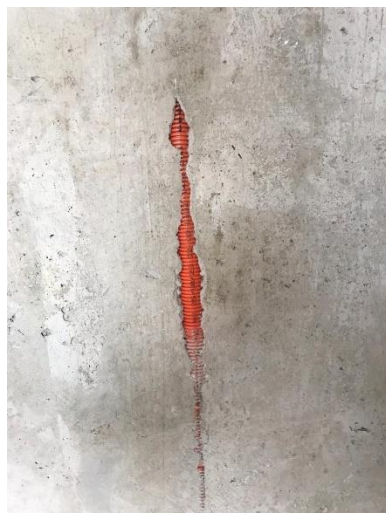
Figura 28 – Eletroduto exposto na superfície do concreto
