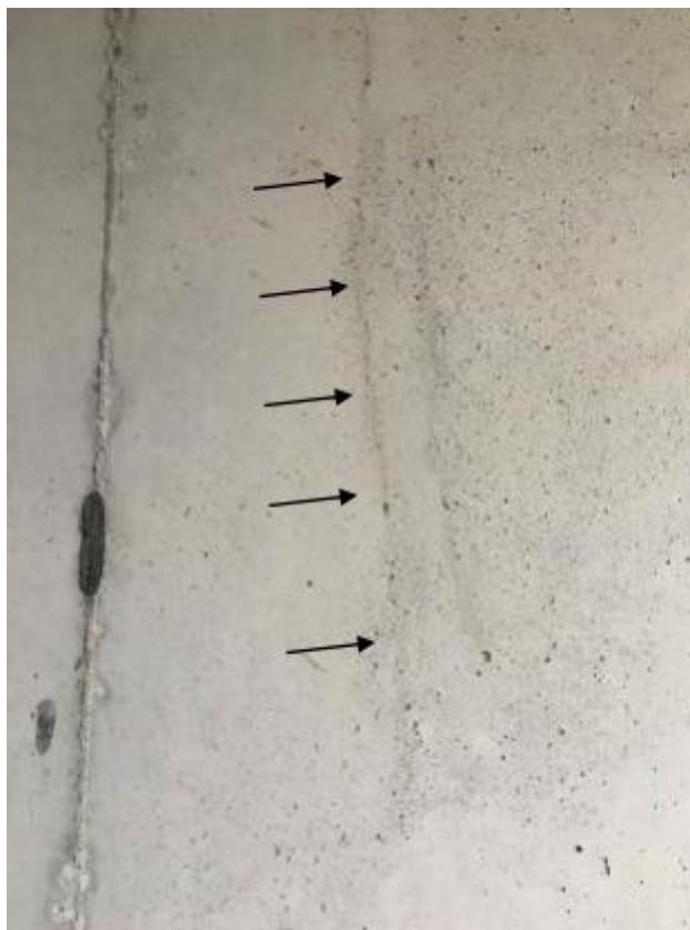
Figura 21 – Fissura em parede sem abertura próxima
