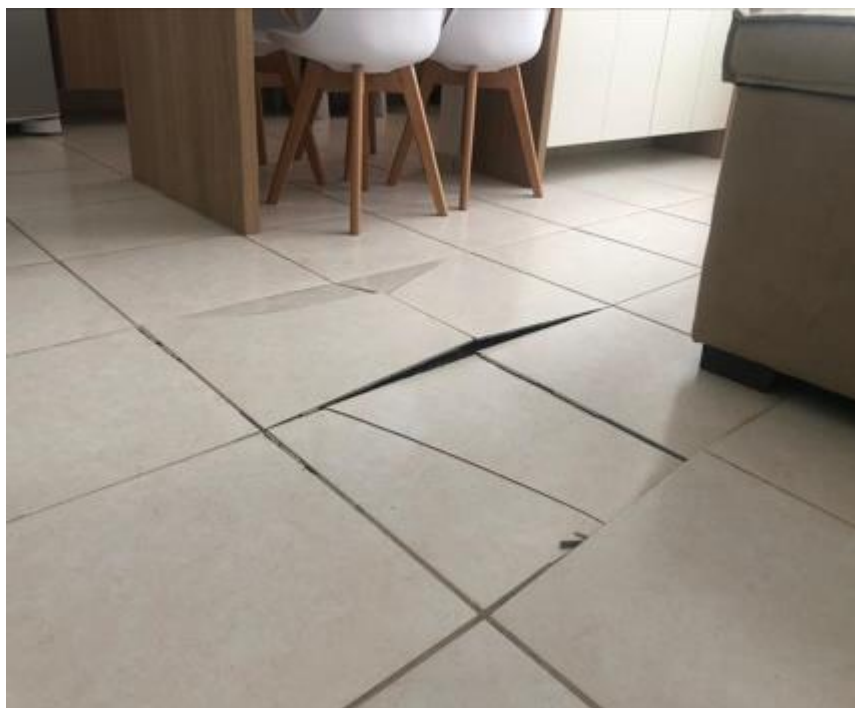
Figura 15 – Deslocamento cerâmico no piso
