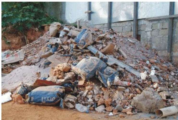
Figura 2 – Resíduos gerados no sistema construtivo de alvenaria convencional
