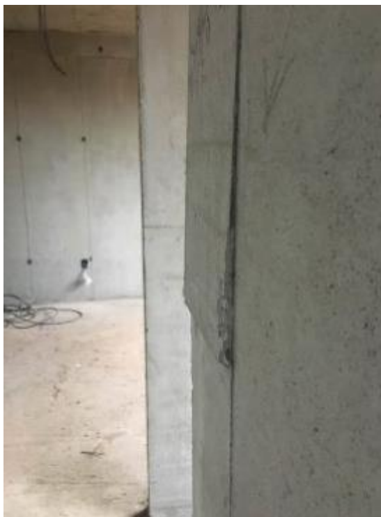
Figura 31 – Defeito na geometria resultante da separação entre as placas
