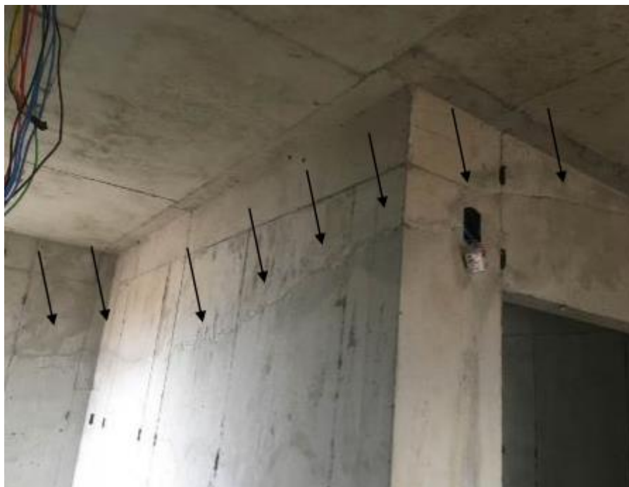
Figura 30 – Juntas frias identificadas no projeto em análise
