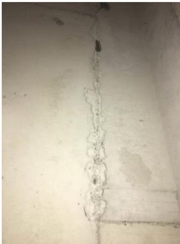
Figura 23 – Segregação no entorno da junta entre fôrmas
