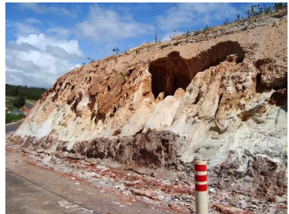
Figura 09: Ausência ou insuficiência de dispositivo de drenagem de proteção de corte adequada para o tipo de material existente no local, com ravinamento e escorregamento do talude de corte. Fonte: arquivo pessoal/2012
