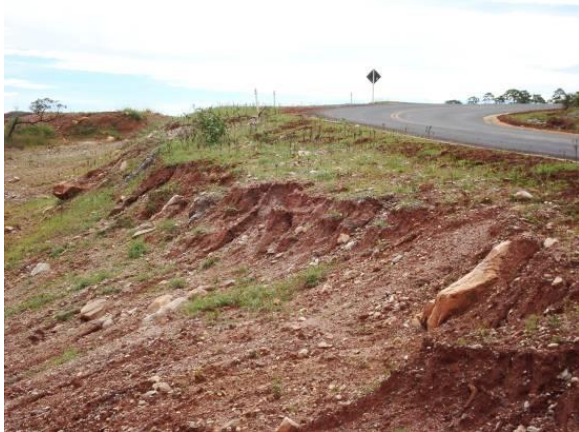
Figura 08: Talude de aterro sem a devida conformação topográfica e revegetação, favorecendo o desenvolvimento de processos erosivos e carreamento de material para curso d'água. Fonte: arquivo pessoal/2012
