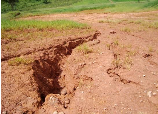
Figura 06: Área de empréstimo com deficiência na conformação topográfica com direcionamento adequado das águas e insuficiência de cobertura vegetal, com desenvolvimento de processos erosivos com perda de solo e carreamento de sedimentos para áreas a jusante. Fonte: arquivo pessoal/2012
