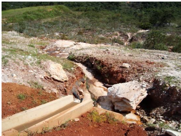
Figura 12: Obstrução de talvegues com material de segunda e terceira categoria, com carreamento de sedimentos e assoreamento de campo rupestre e cursos d'água a jusante de drenagens. Fonte: arquivo pessoal/2012
