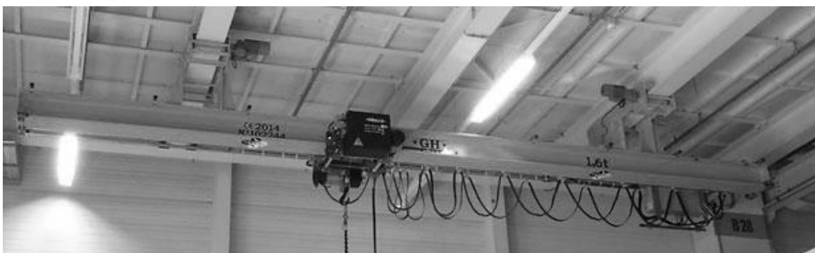
Figura 4: Ponte rolante suspensa.
