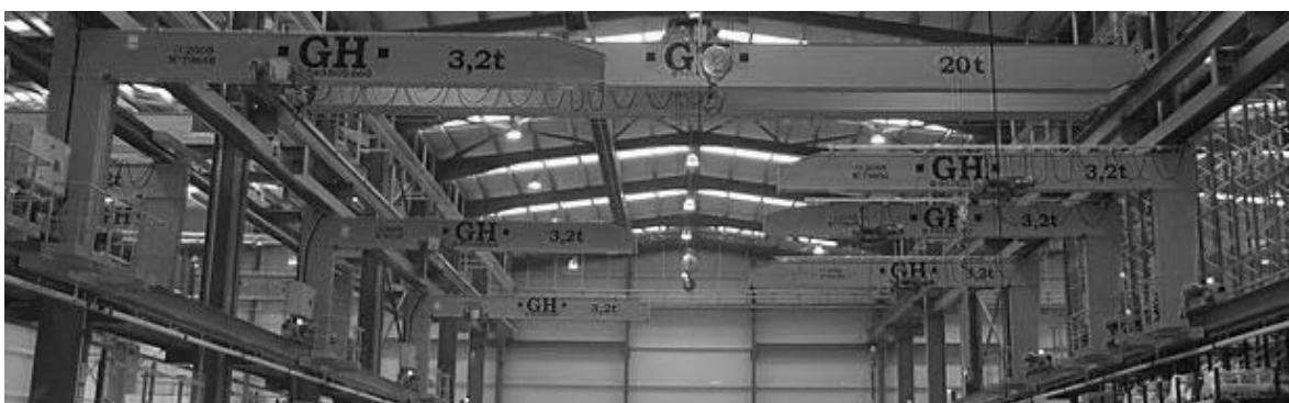
Figura 5: Ponte Rolante Por Suporte.
