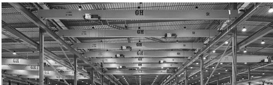
Figura 3 – Ponte rolante monoviga.
