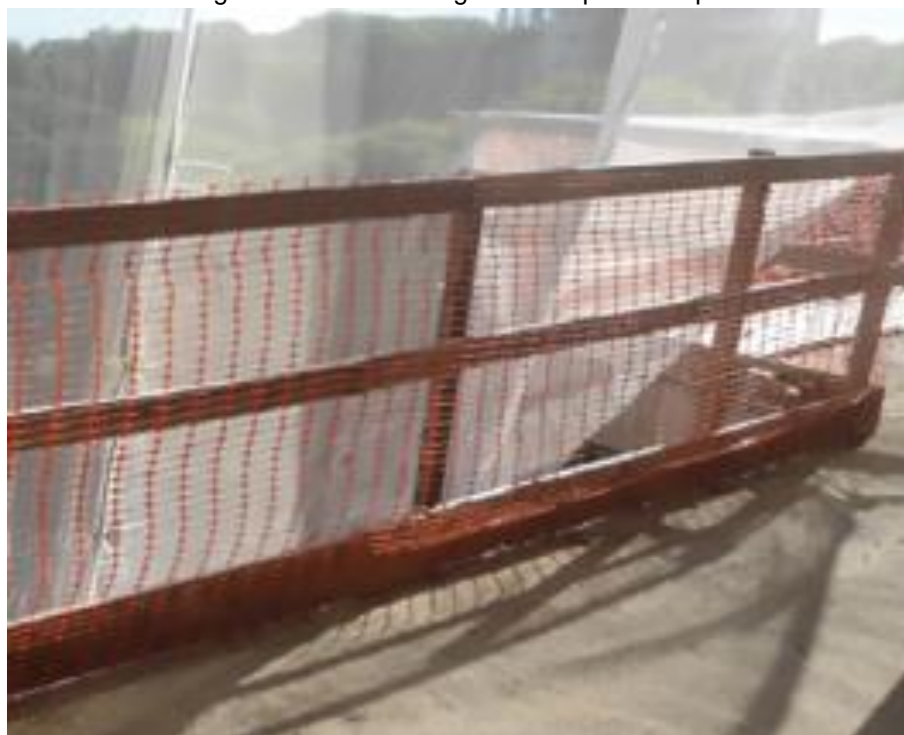
Figura 1 - Sistema de guarda-corpo e rodapé.
