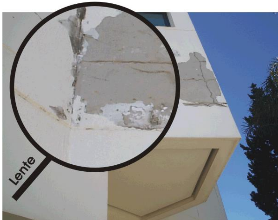
Figura 20 – Descolamento de reboco
