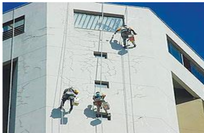
Figura 18 – Fissuração mapeada causada por retração de secagem de argamassa
