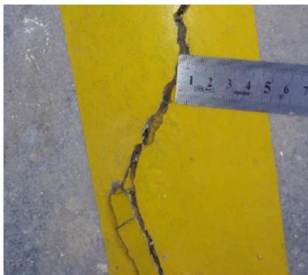
Figura 07 - Piso do pilotis com trinca
