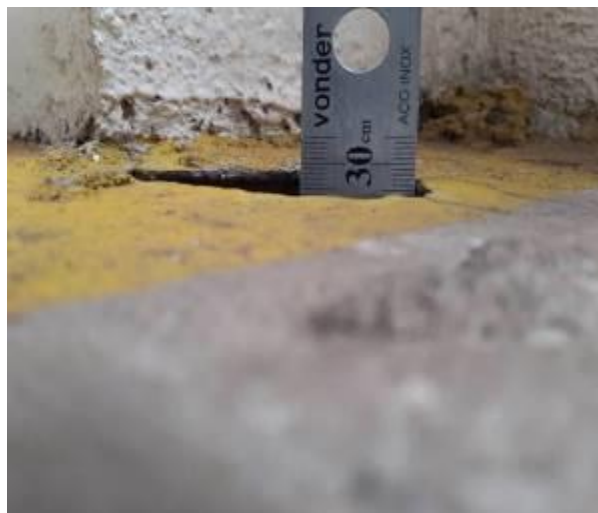
Figura 38 - Recalque no aterro do estacionamento coberto/pilotis.
