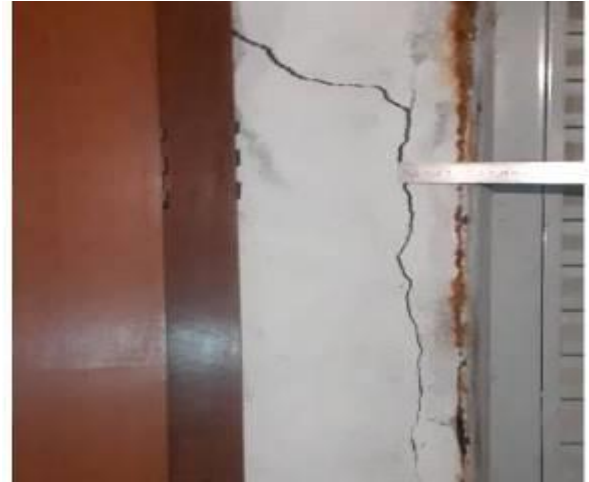
Figura 48 – Banheiro 2 do subsolo 1
