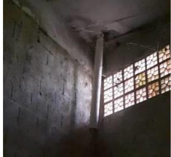
Figura 53 - Sistema de drenagem não concluído
