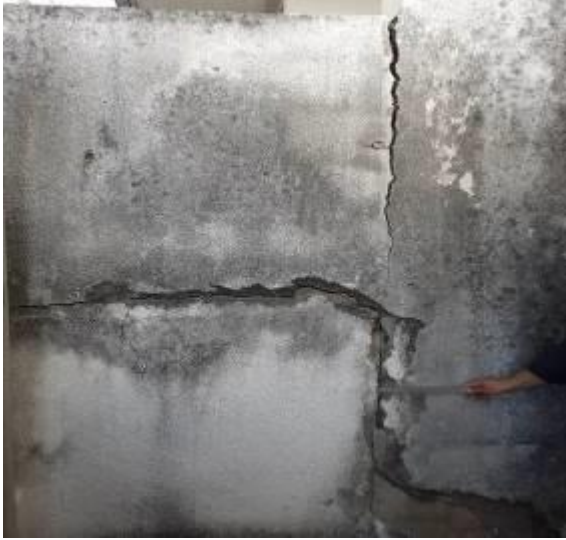
Figura 44 – Rachadura no muro de contenção
