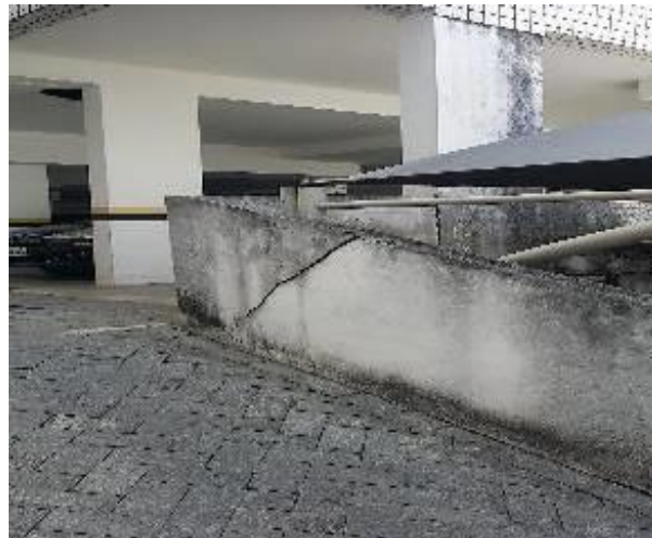
Figura 42 – Trinca na parede guarda corpo da rampa de acesso no estacionamento 2
