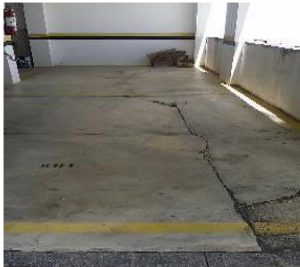
Figura 34 - Piso com afundamento/recalque
