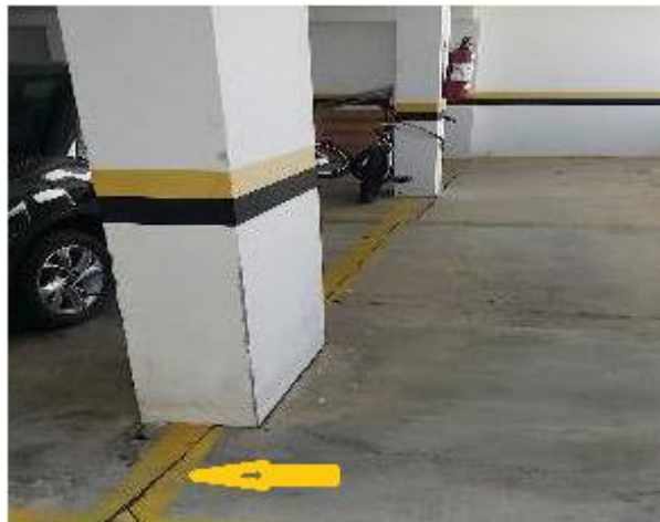
Figura 32 - Piso com afundamento/recalque
