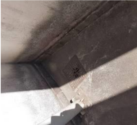
Figura 52 - Sistema de drenagem não concluído
