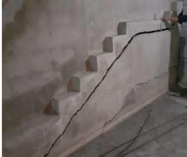
Figura 50 - Rachadura na parede da escada de acesso ao subsolo 1
