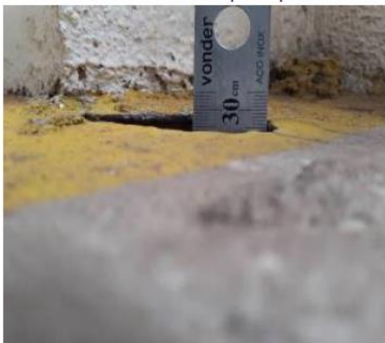
Figura 05 – Piso com afundamento/recalque no pilotis do estacionamento 1
