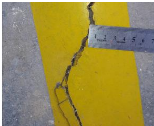
Figura 36 - Piso do pilotis com trinca
