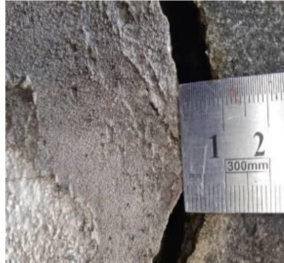
Figura 45 – Rachadura no muro de contenção
