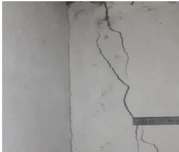
Figura 55 – Trincas na parede dos fundos dos banheiros
