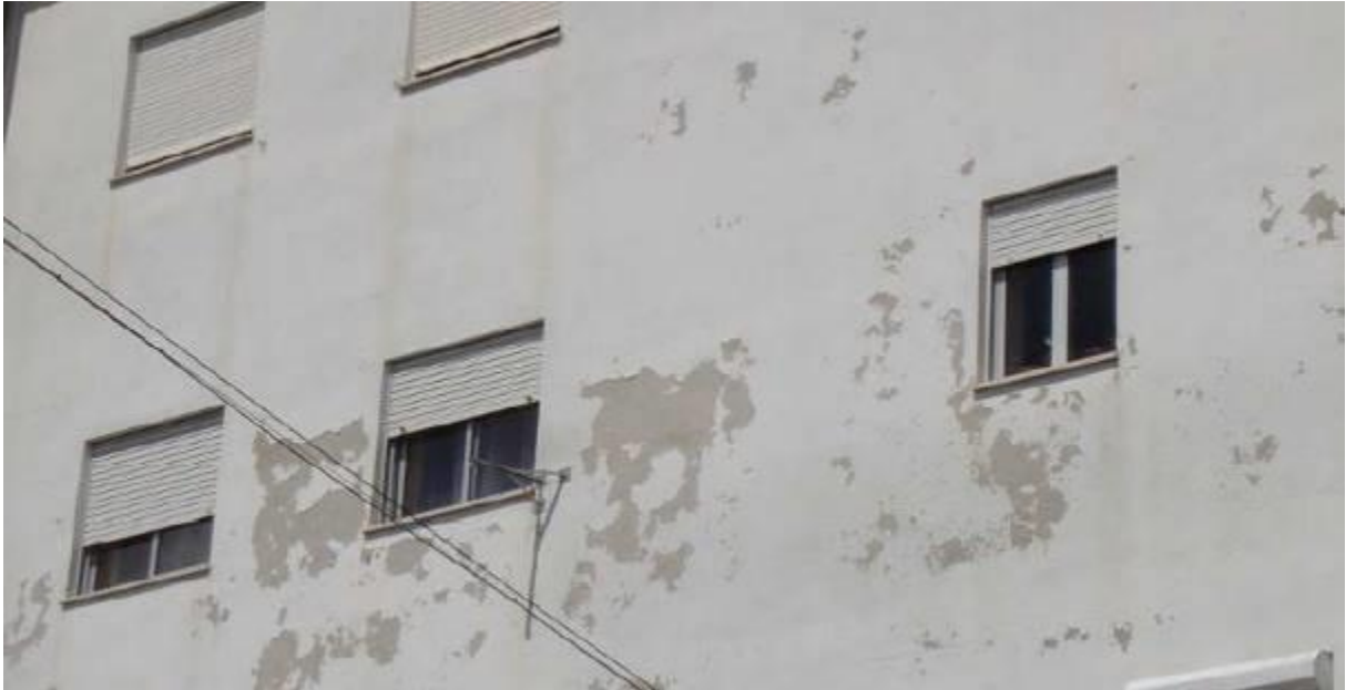
Figura 21 – Descolamento de pintura
