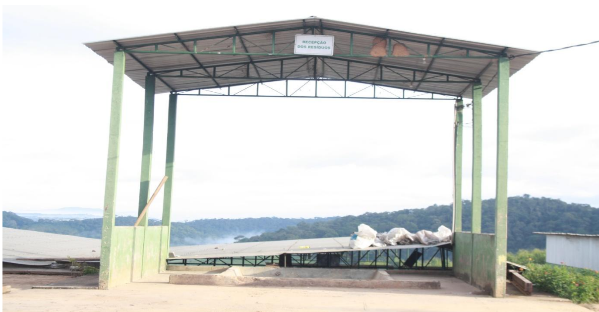
Recepção dos resíduos
