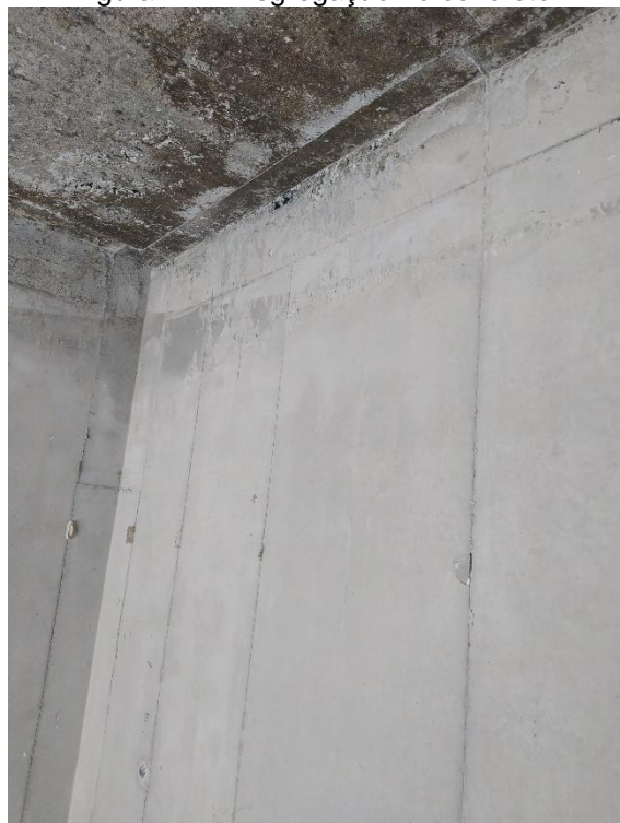
Figura 44 – Disgregação no concreto.
