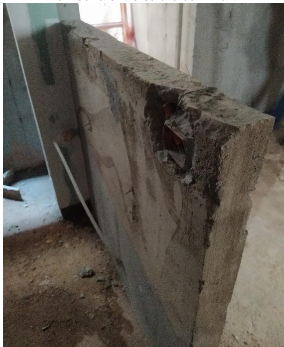
Figura 65 – Falta de concreto na parede divisória entre sala e cozinha.
