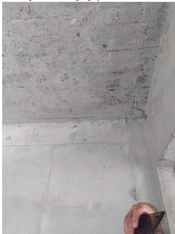
Figura 53 – Segregação no concreto.
