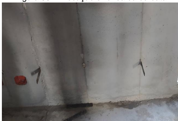
Figura 56 – Alocação errônea da corbata.
