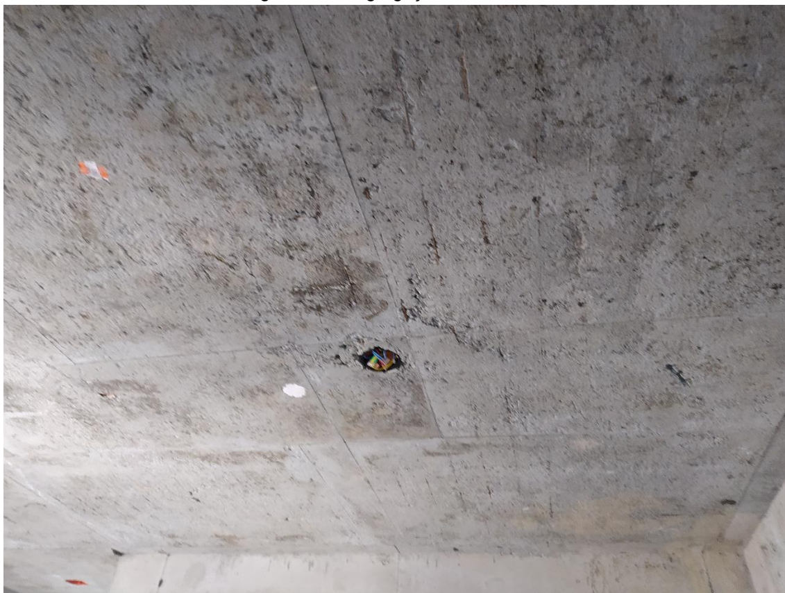
Figura 51 – Segregação no concreto.
