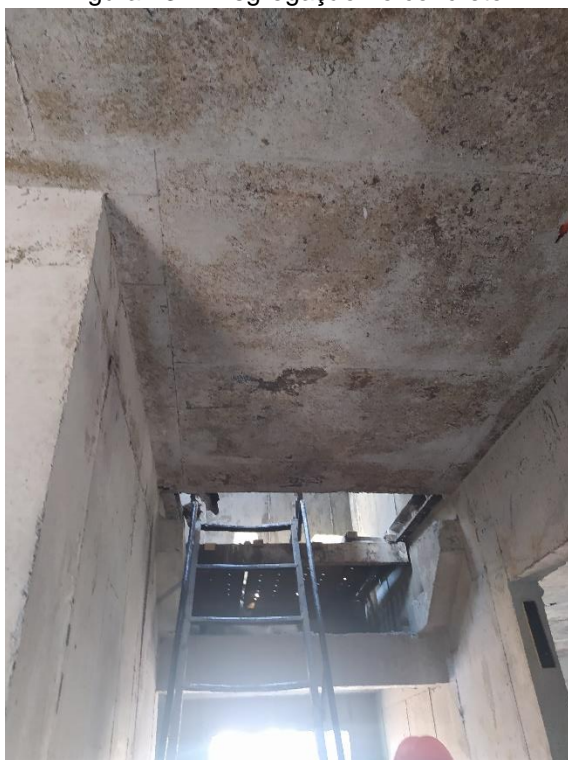
Figura 43 – Disgregação no concreto.
