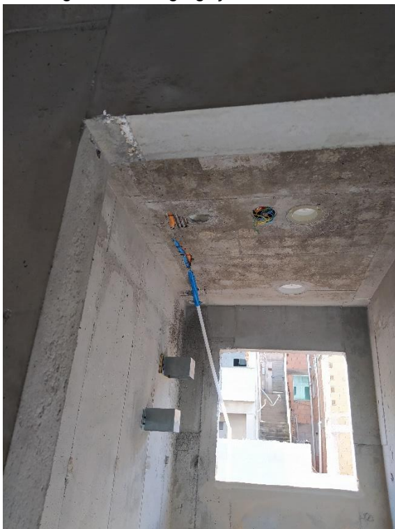
Figura 52 – Segregação no concreto.
