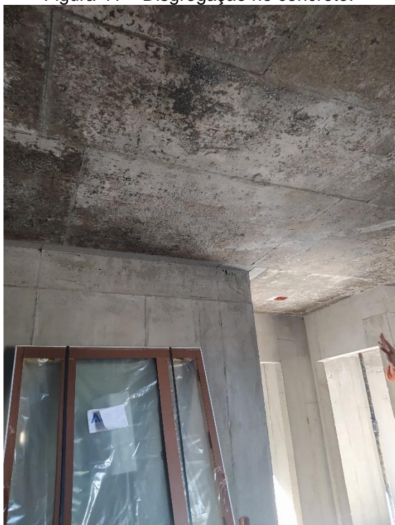
Figura 41 – Disgregação no concreto.
