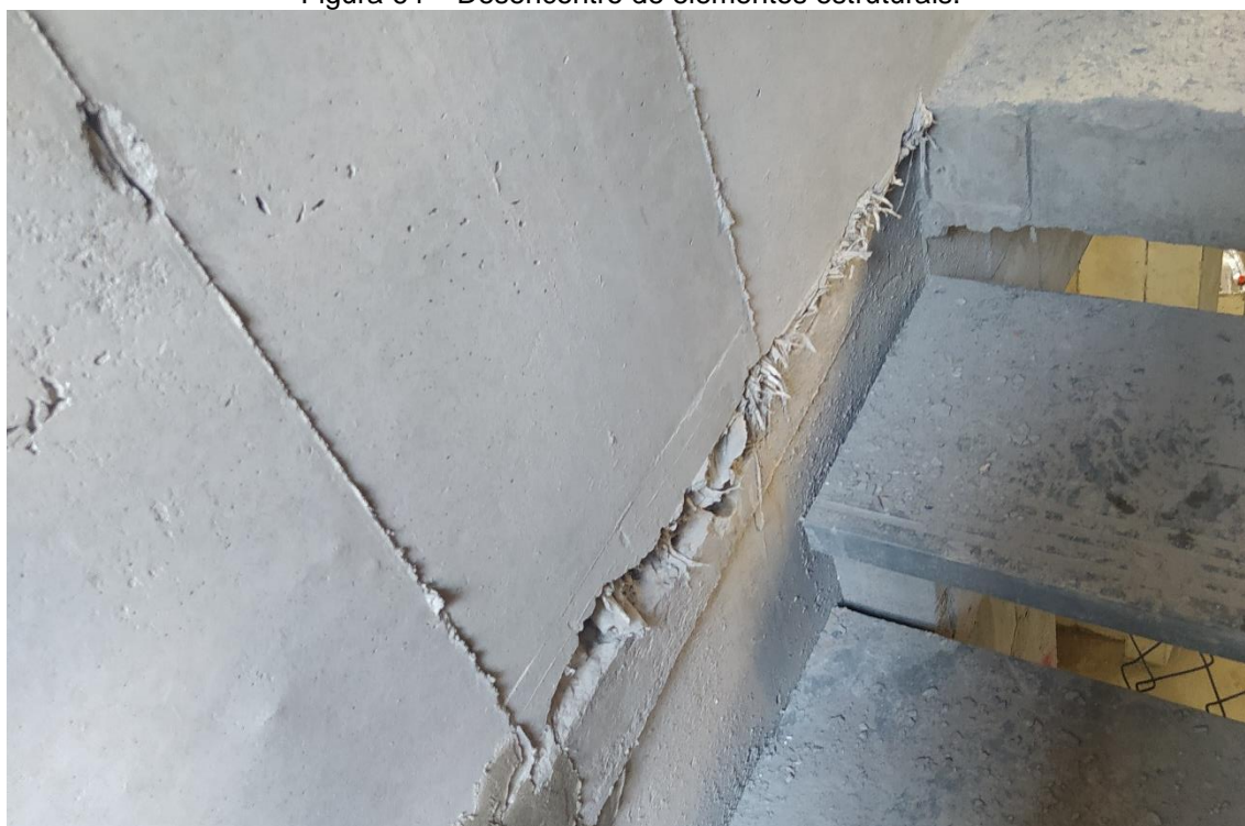
Figura 64 – Desencontro de elementos estruturais.
