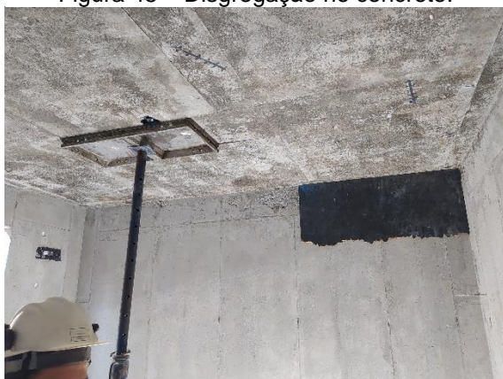
Figura 45 – Disgregação no concreto.
