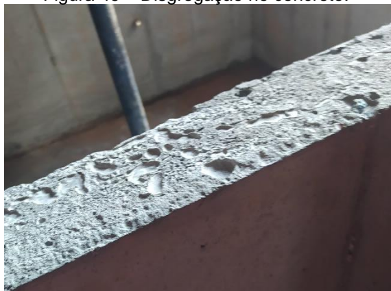
Figura 49 – Disgregação no concreto.
