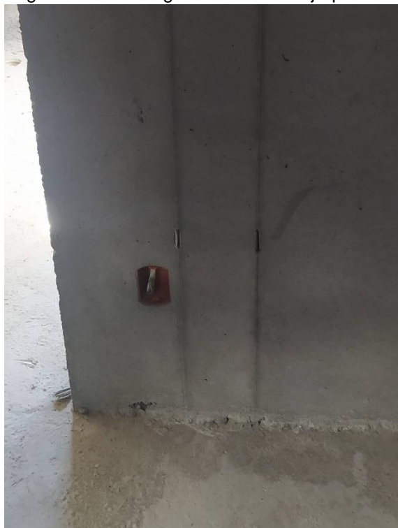
Figura 60 – Patologia no encontro laje-parede.
