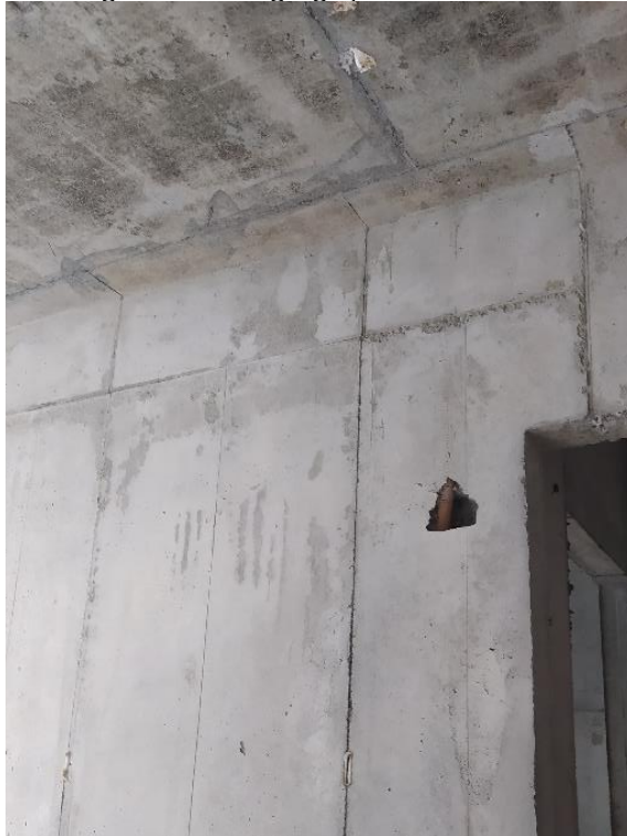
Figura 55 – Segregação no concreto.
