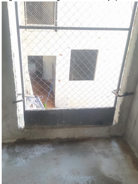
Figura 61 – Patologia no encontro laje-parede.
