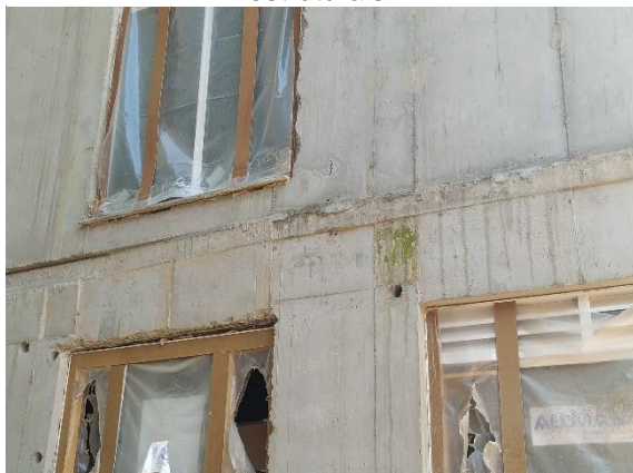
Figura 62 – Desencontro de elementos estruturais.
