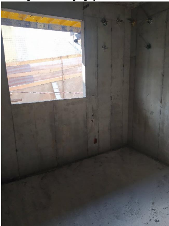
Figura 54 – Segregação no concreto.
