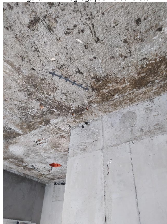
Figura 42 – Disgregação no concreto.
