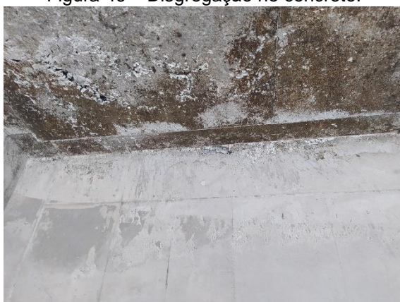
Figura 46 – Disgregação no concreto.
