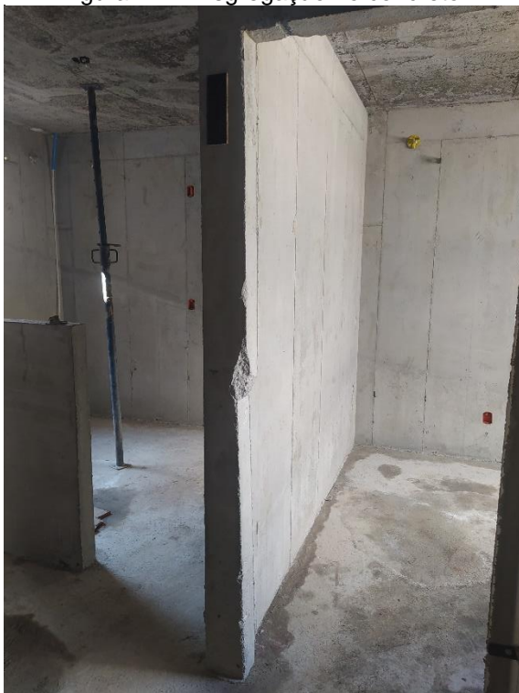
Figura 47 – Disgregação no concreto.
