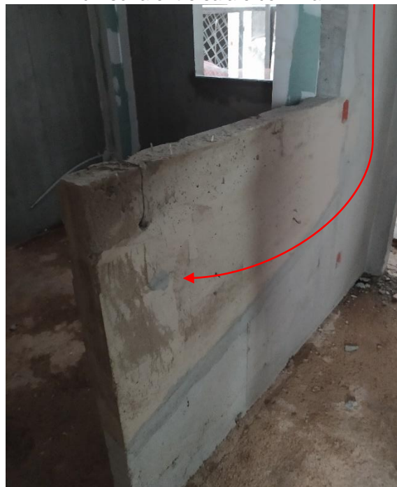
Figura 66 – Falta de concreto na parede divisória entre sala e cozinha.
