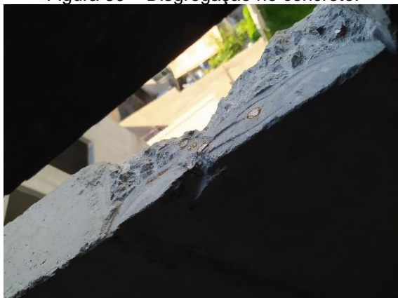
Figura 50 – Disgregação no concreto.
