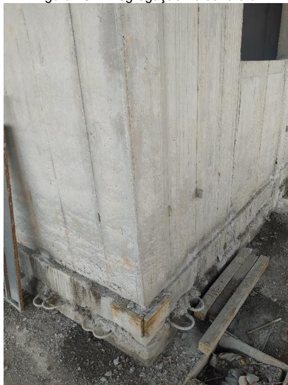
Figura 48 – Disgregação no concreto.
