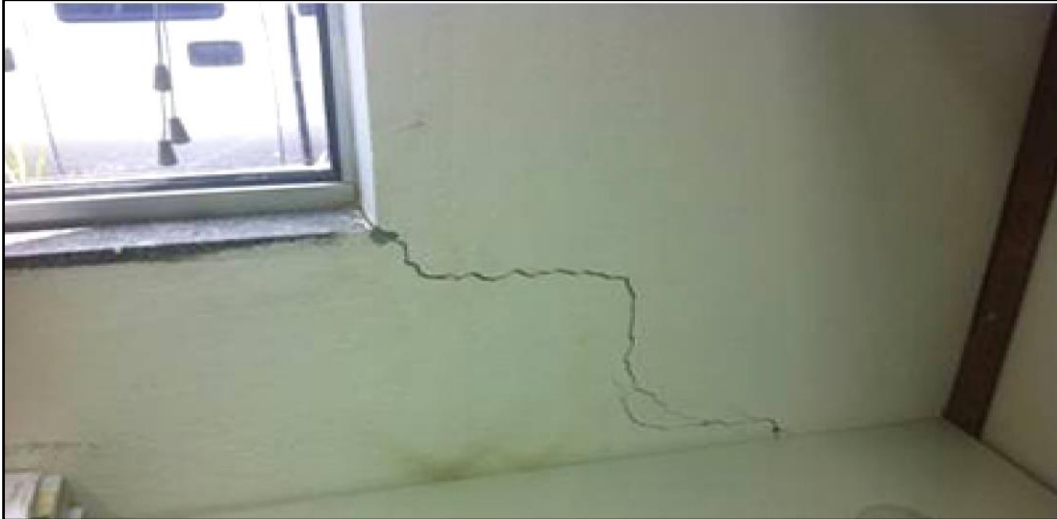
Figura 10 - Exemplo de anomalia devido à falta de contra verga
