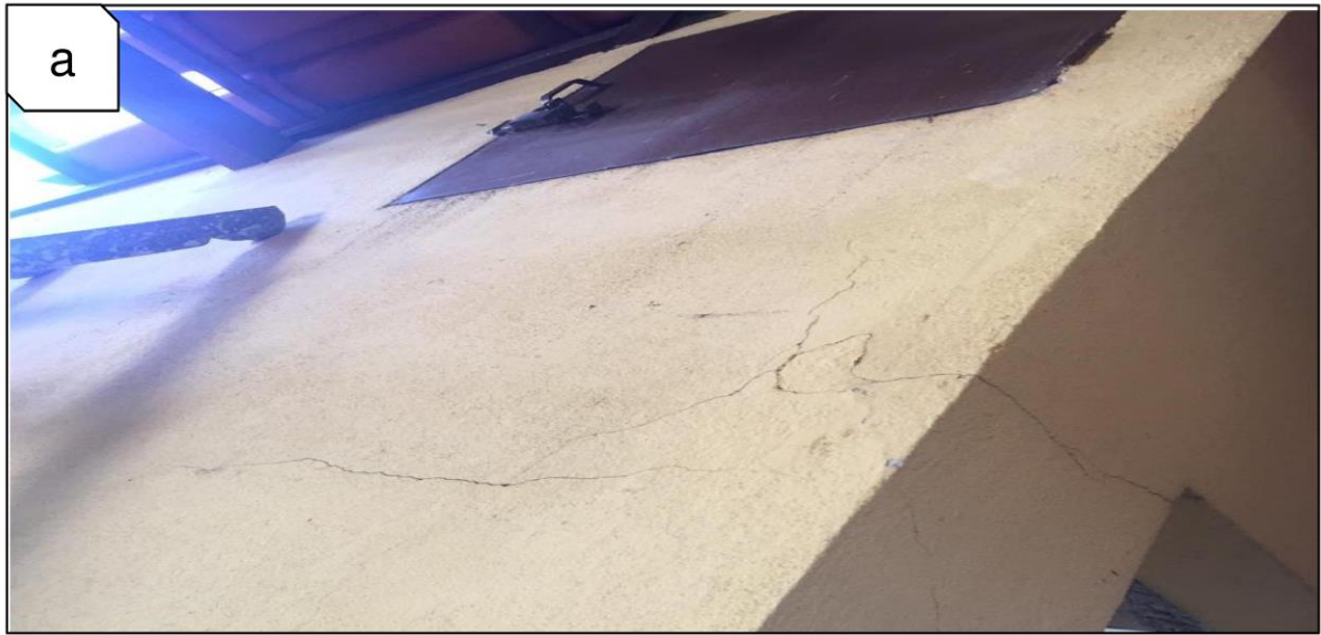
Figura 15 – Registros fotográficos sobre as anomalias observadas
