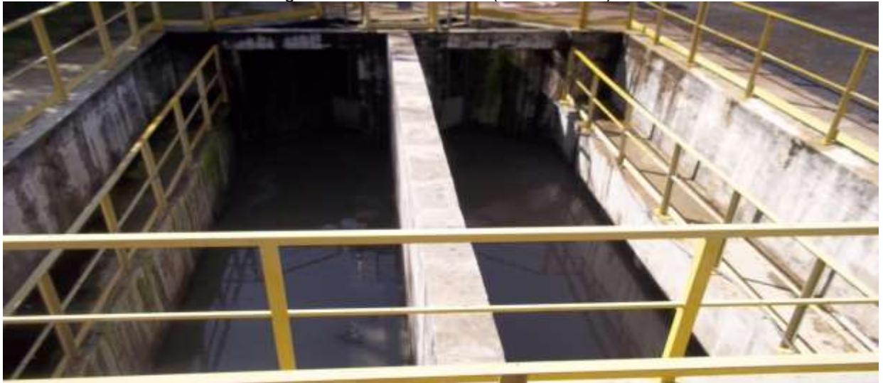
Figura 3: Caixas de Areia (desarenador)
