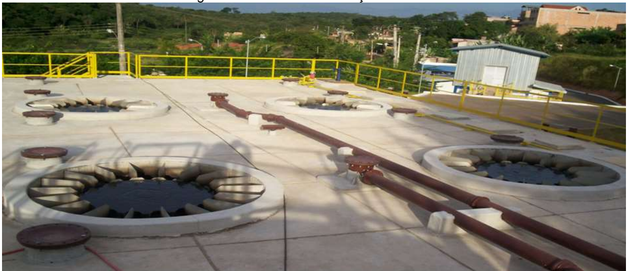
Figura 4: Caixas de Distribuição de Vazão
