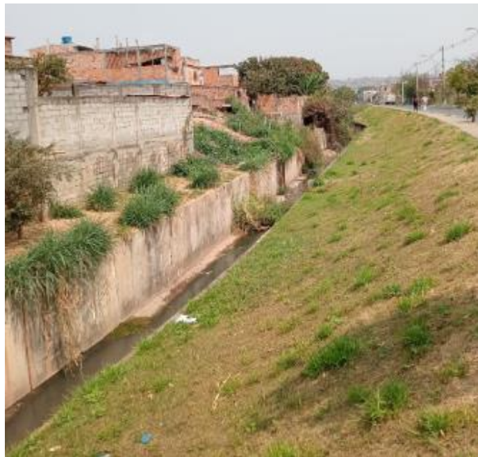
FIGURA 2 - Córrego obras de drenagem com canaleta, pavimentação asfáltica construções ao lado do leito do córrego.
